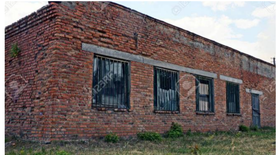
A base de ladrillo de 30 cm de espesor, cubierta a base de bovedilla con aislamiento y plafón interior.
